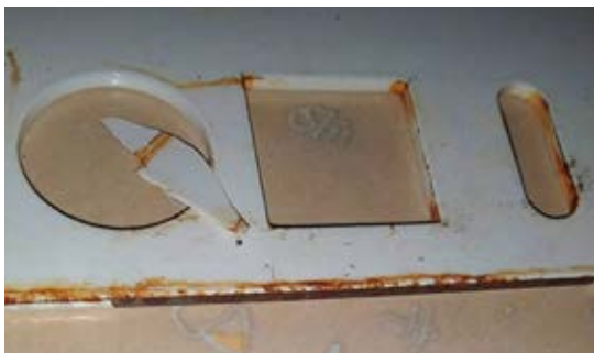
Versuchsblech mit abgeplatzter Beschichtung an der Laserkante
